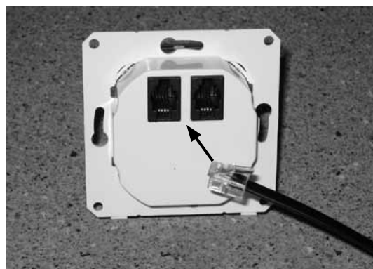
Anslutning av styrkabel.
